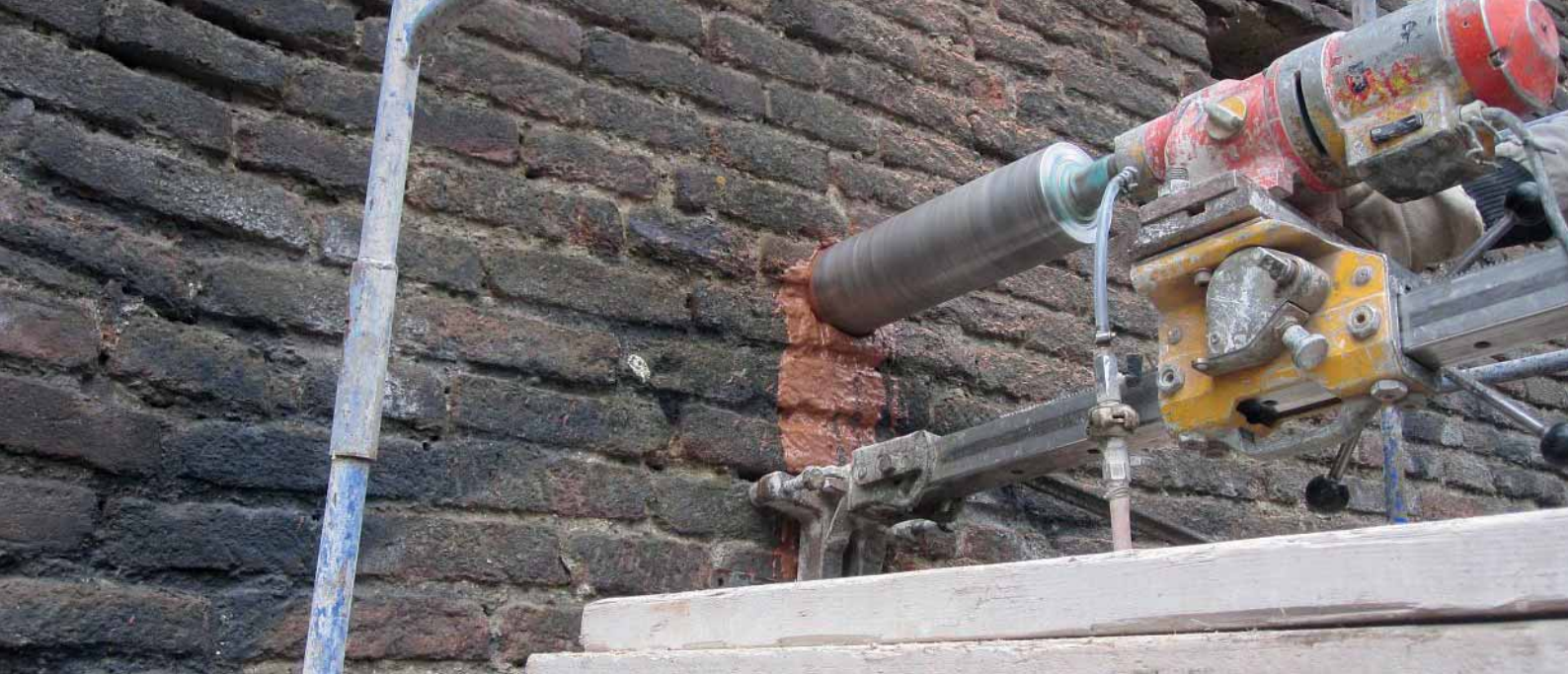
U Bruských kasáren Praha, průzkum těles opěrné zdi
