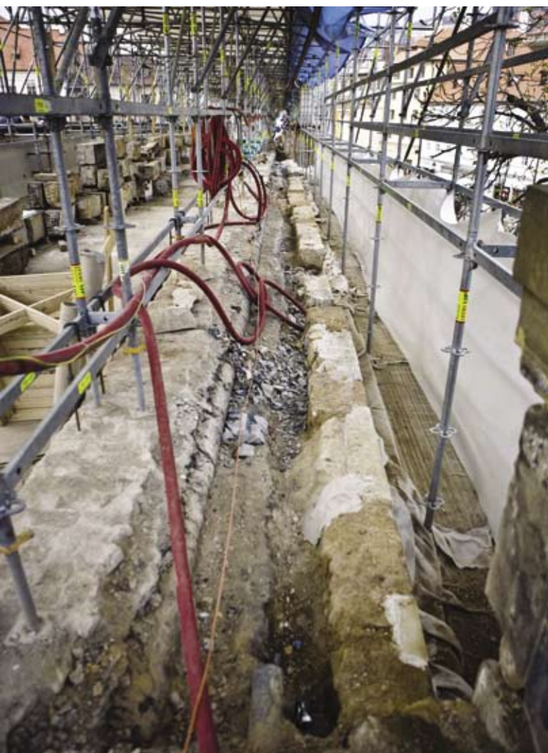
▲ Rozebraná část zábradlí mostu
